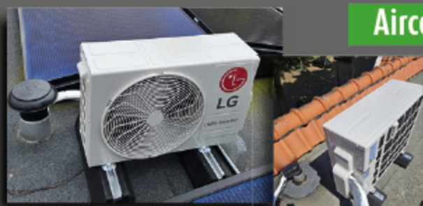
Airco split-unit (buiten)
